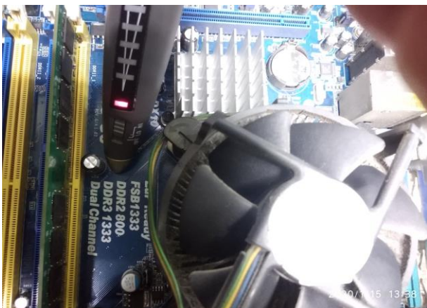
圖 檢查 PCB 線路雜訊
